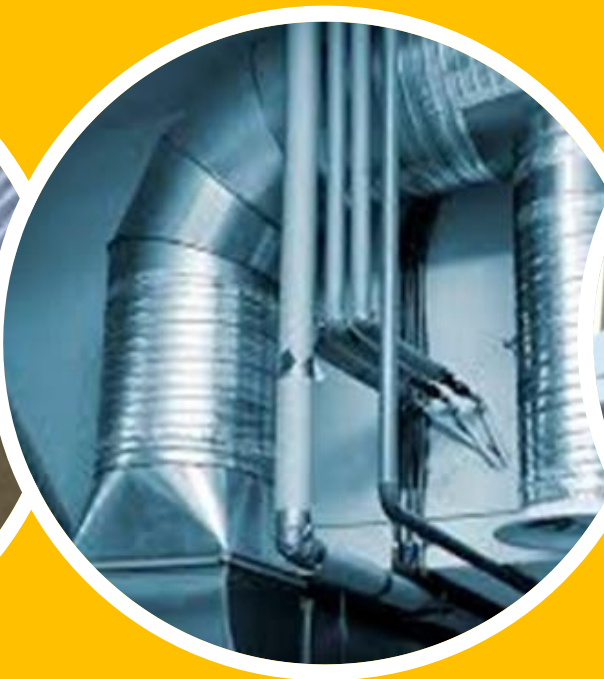
Dutos de ventilação e ar condicionado
