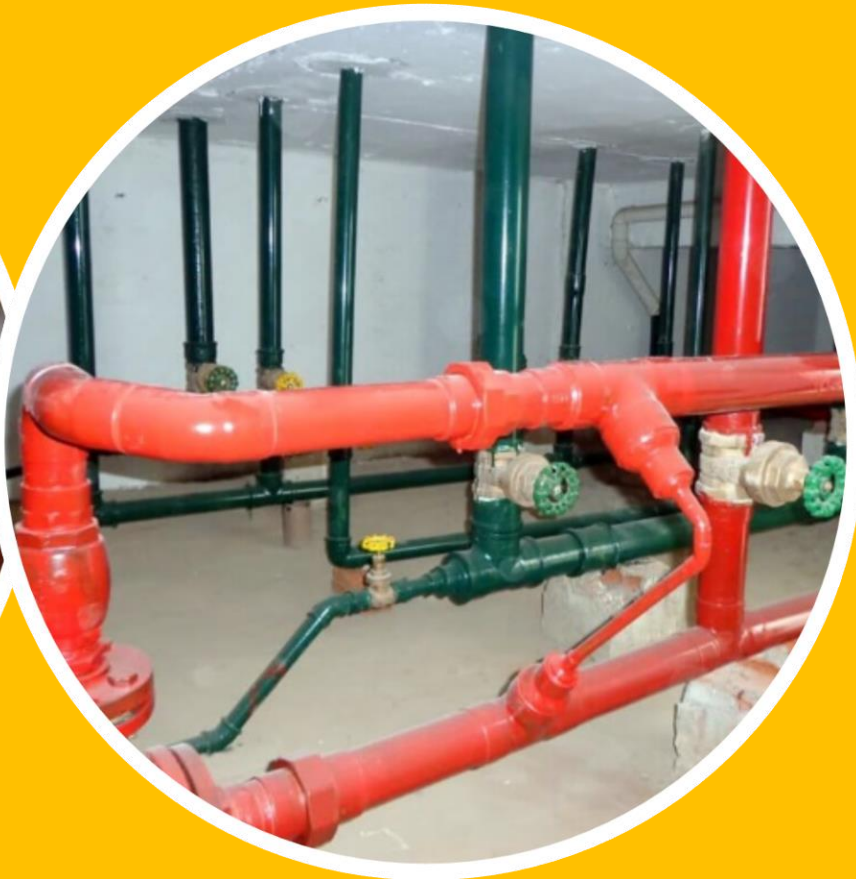
Saídas de tubulação / barriletes
