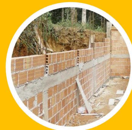
Paredes sujeitas a infiltração
